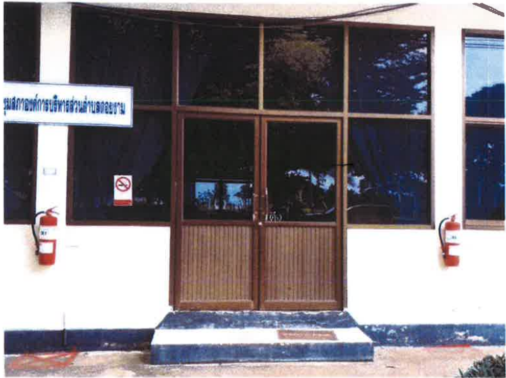
มีถังดับเพลิง
